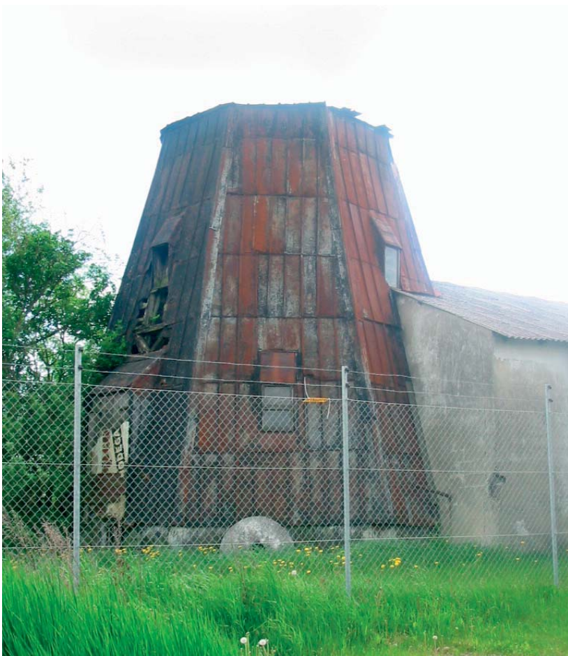
Til venstre: Tendrup gamle mølle er i meget dårlig stand og fremstår ikke bevaringsværdig.
